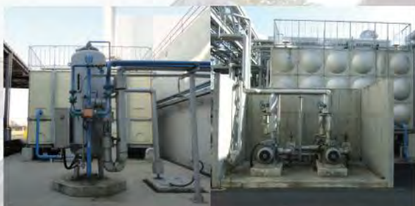
雨水排水貯留設備
