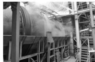
低濃度PCB廃棄物無害化処理システムの焼却溶解炉
